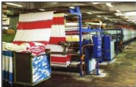
中国の紡織染色工場でモデル実証事業 を実施中の高効率テンター (生地仕上げ乾燥設備)
