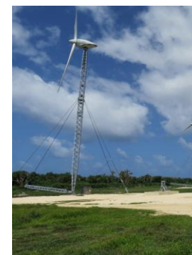
可倒式風力発電 (沖縄電力グループ)
