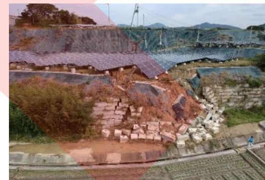
法面保護工が崩れて流出した事例
