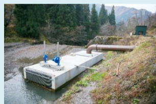
小水力発電施設
